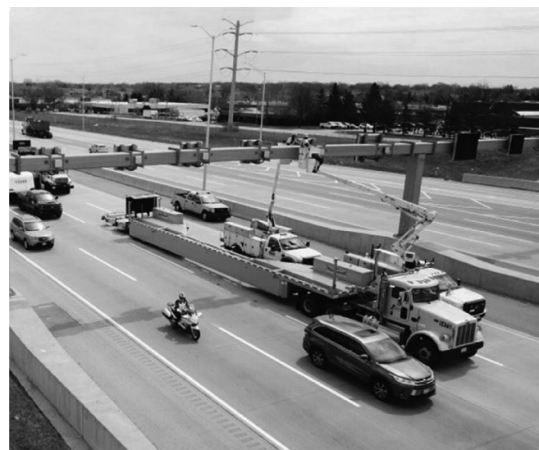
写真一6 大型防護車両
